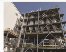
中盐吉兰泰48000KVA密闭电石炉炉气净化回收系统
