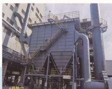
中泰化学40500KVA密闭电石炉炉前排烟除尘系统
