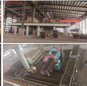
神木市电石集团能源发展有限公司 自动化电石卸料站6套
