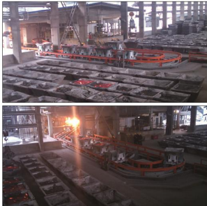
青海盐湖海纳化工有限公司 链式智能化电石输送线3套、自动化电石卸料站1套
